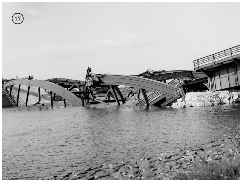
De opgeblazen verkeersbrug bij Hedel.
